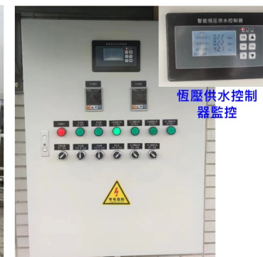
安裝後熱水控制系統
