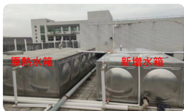
員工宿舍樓頂熱水箱
