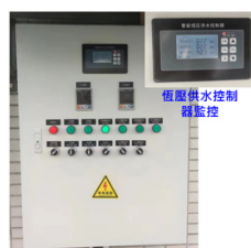
安裝後熱水控制系統
