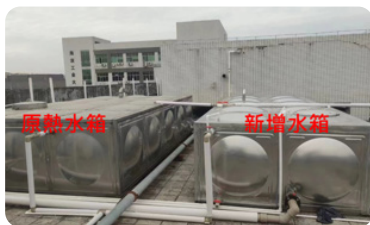
員工宿舍樓頂熱水箱
