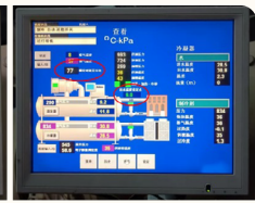
調整後冷凍水設定溫度9°C，主機負載77%
