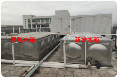
員工宿舍樓頂熱水箱
