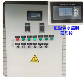
安裝後熱水控制系統
