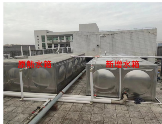
員工宿舍樓頂熱水箱
